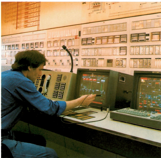
Meßwarte in der Schlammbehandlung – die Überwachung geschieht mit Hilfe bildschirmgestützter Prozessleitsysteme.
